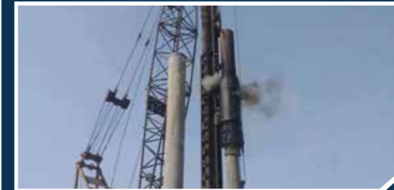
Thiết bị: Búa Diesel 3,5T Nước SX: Trung Quốc Số lượng: 10 - Tính năng: Hạ cọc tròn DUL BTCT D500A
