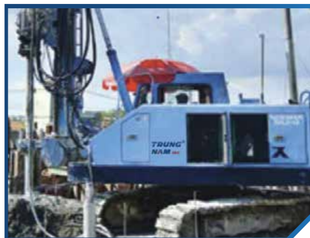
设备：钻机 XMD 产地：日本 - 数量：4台 用途：钻孔及地基加固
